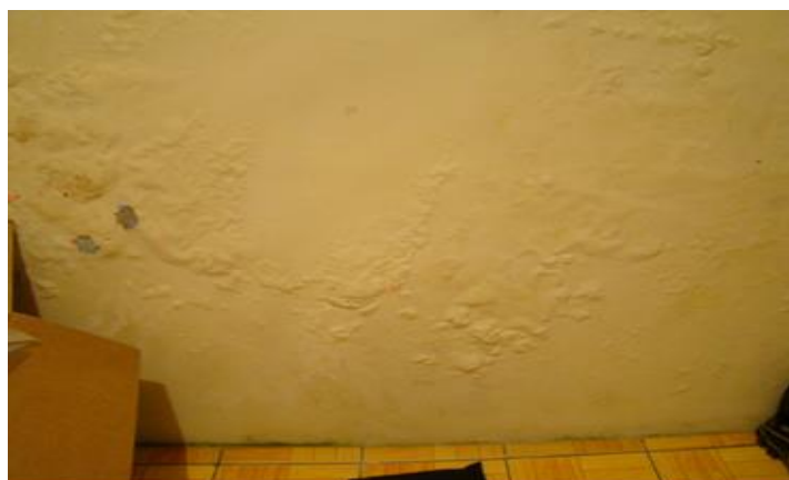
Figura 18. Bolhas na pintura. Falta de fundo preparador para pintura e umidade
