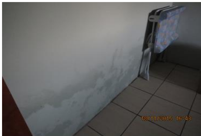
Figura 13. Umidade e bolor em parede: Manchas Fonte: Dados de vistorias/laudos/autor da pesquisa
