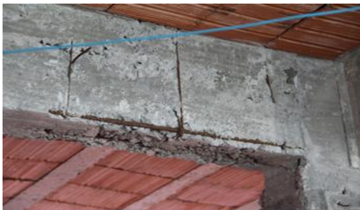
Figura 5. Falha de concretagem, armadura aparente e cobertura insuficiente
