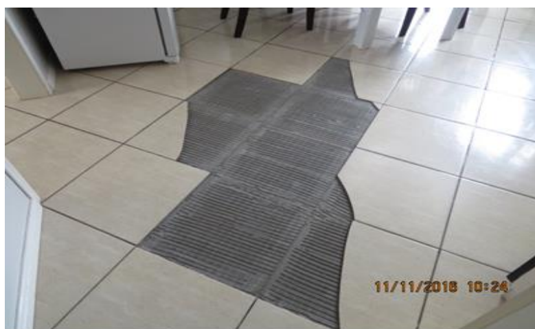
Figura 26. Deslocamento de piso por mau assentamento e deformação excessiva da laje
