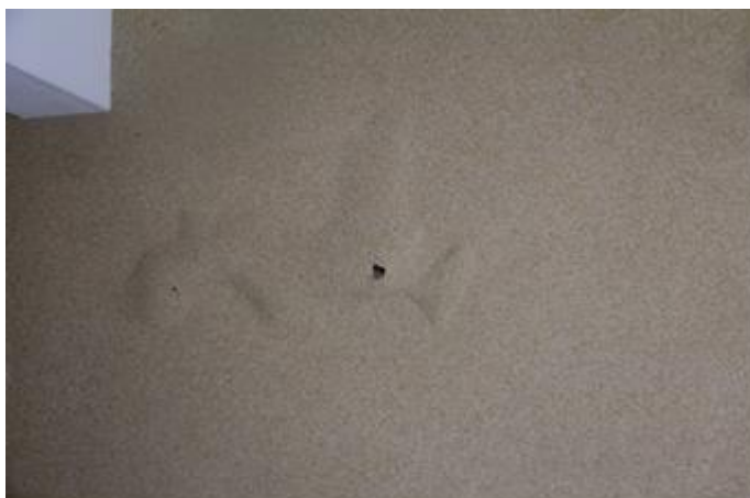
Figura 15. Bolhas (deslocamento da pintura) Fonte: Dados de vistorias/laudos/autor da pesquisa
