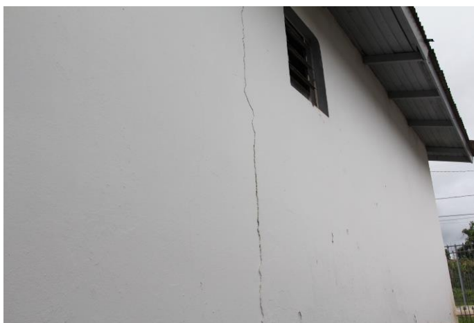
Figura 8. Fissura vertical no encontro de paredes – provável falta de amarração entre as paredes Fonte: Dados de vistorias/laudos/autor da pesquisa
