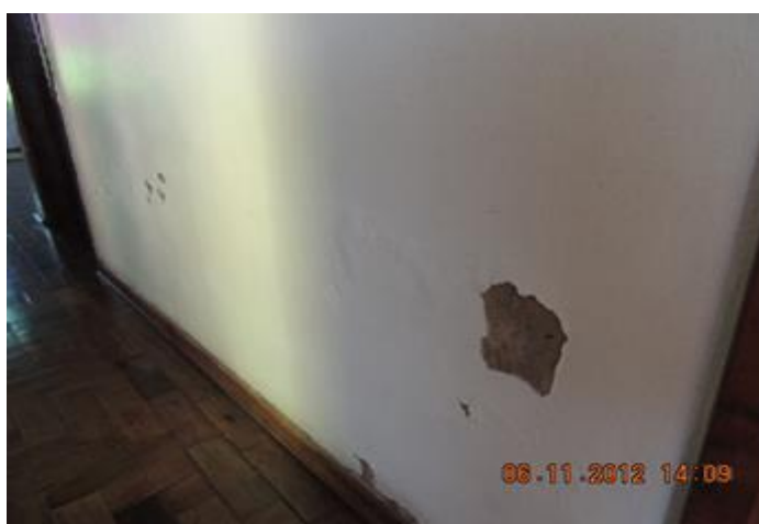
Figura 16. Filme de tinta soltando devido à umidade e falta de fundo preparador para pintura Fonte: Dados de vistorias/laudos/autor da pesquisa
