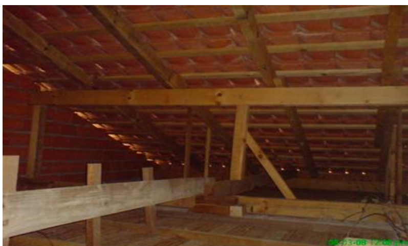
Figura 22. Subdimensionamento e projeto indevido de estrutura do telhado
