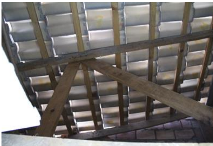
Figura 21. Subdimensionamento da estrutura de madeira do telhado
