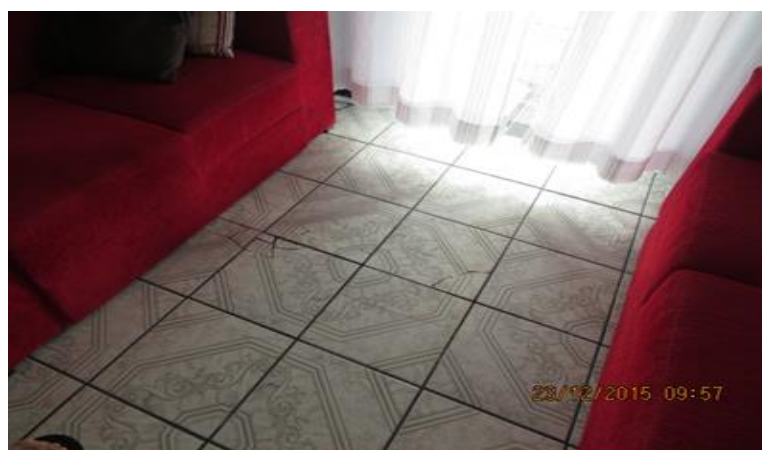
Figura 24. Trinca em piso devido à deformação excessiva da laje e aplicação inadequada da argamassa.
