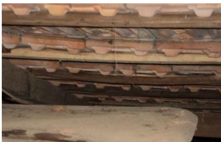
Figura 19. Subdimensionamento da estrutura de madeira do telhado
