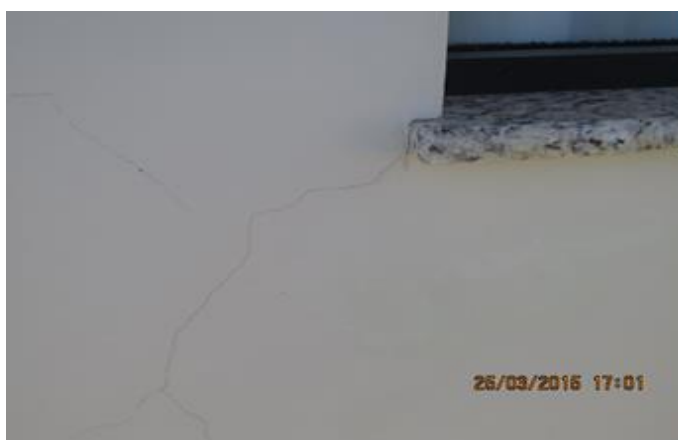
Figura 3. Fissura devido à falta de contra-verga em abertura
