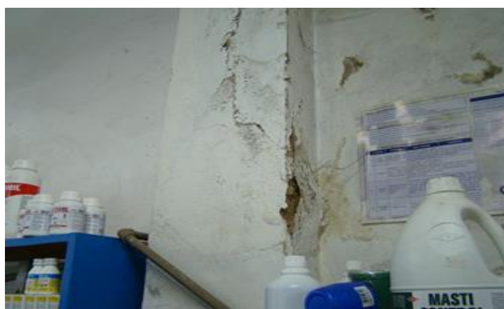
Figura 14. Reboco pulverulento e soltando devido umidade Fonte: Dados de vistorias/laudos/autor da pesquisa
