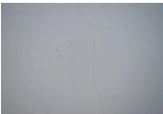
Figura 7. Mapeamento de reboco Fonte: Dados de vistorias/laudos/autor da pesquisa
