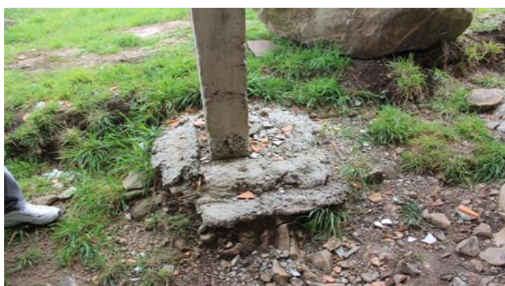
Figura 6. Pilar sem amarração com vigas e inexistência de sapata no solo
