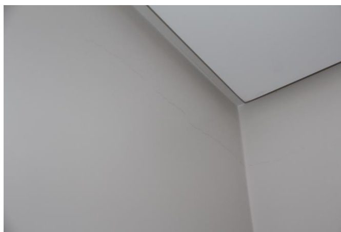
Figura 10. Fissuras horizontal em parede – falta de encunhamento adequado da alvenaria com a estrutura
