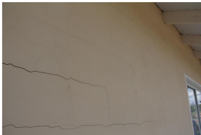
Figura 09. Fissuras generalizadas em parede - massa fraca e som cavo ao toque, indicando reboco solto
