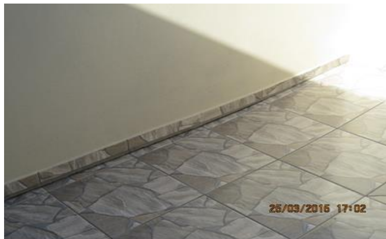
Figura 25. Piso cedeu devido à acomodação de aterros
