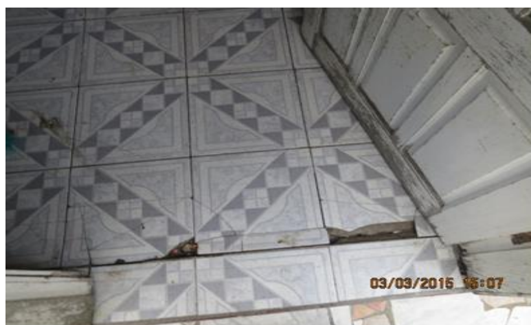
Figura 23. Trinca em piso cerâmico – erro de assentamento, descolamento da argamassa
