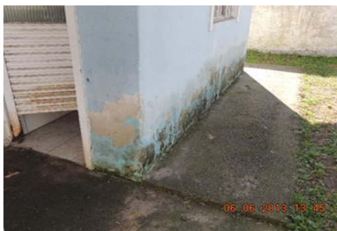
Figura 11. Umidade e bolor em parede Fonte: Dados de vistorias/laudos/autor da pesquisa
