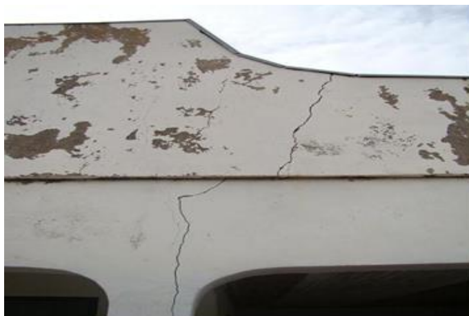
Figura 17. Pintura deteriorada. Falta de fundo preparador para pintura e mais demãos
