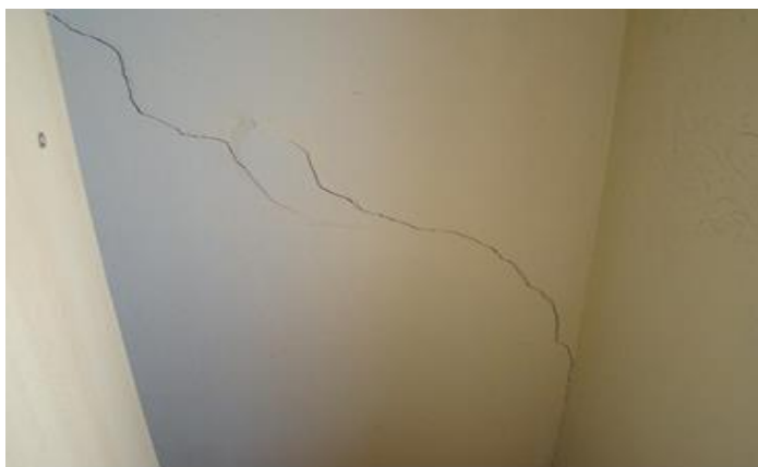
Figura 4. Fissura em parede devido ao recalque de fundação
