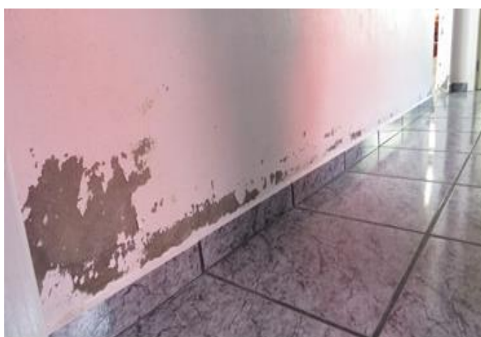
Figura 12. Umidade ascendente devido à falta de impermeabilização das vigas baldrame Fonte: Dados de vistorias/laudos/autor da pesquisa
