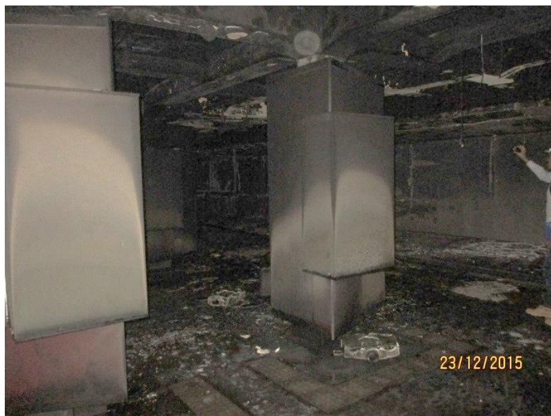
Figura 2 – Estrutura do museu da língua portuguesa não danificada pela ação da temperatura, contudo completamente impregnada por fuligem (fonte: relatório “L4257C-15 – FINAL – REV.00” elaborado pela empresa Critério Engenharia, Marcelli, L., 2016)
