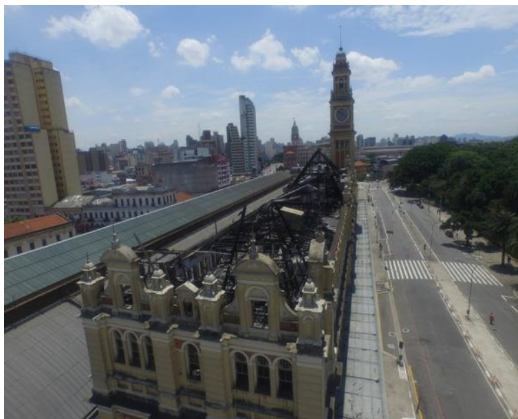
Figura 1 – Vista aérea do Museu da Língua Portuguesa após incêndio (fonte: relatório “L4257C-15 – FINAL – REV.00” elaborado pela empresa Critério Engenharia, Marcelli, L., 2016)
