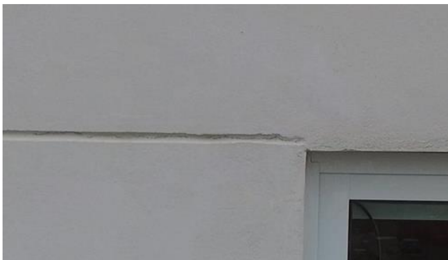
Figura 19: Fissura na junta de dilatação
