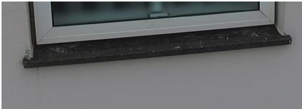
Figura 22: Mancha de umidade em revestimento
