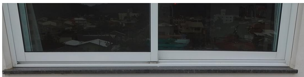
Figura 23: Trincas na parte inferior das janelas.
