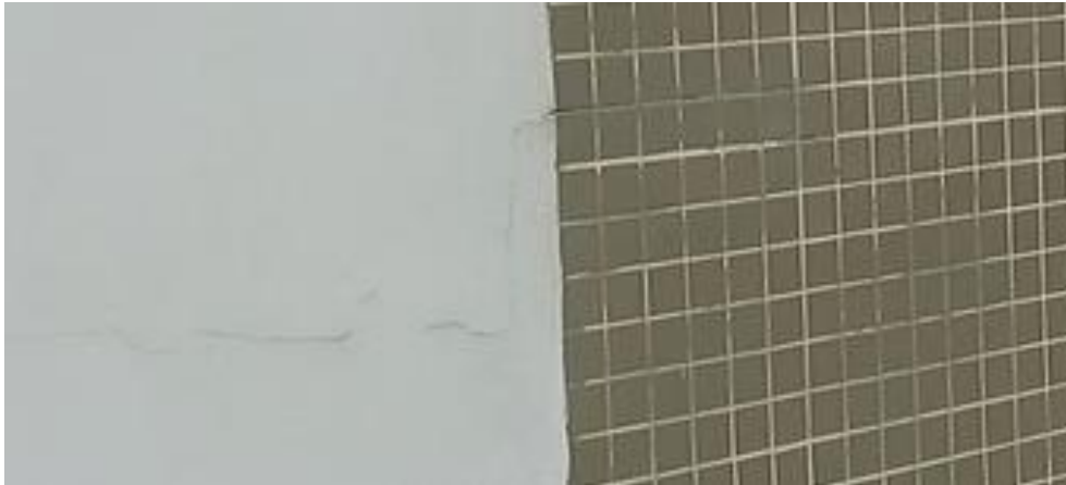
Figura 21: Fissura em revestimento com pintura e cerâmico
