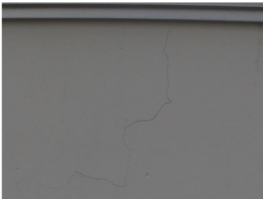
Figura 18: Fissura na platibanda
