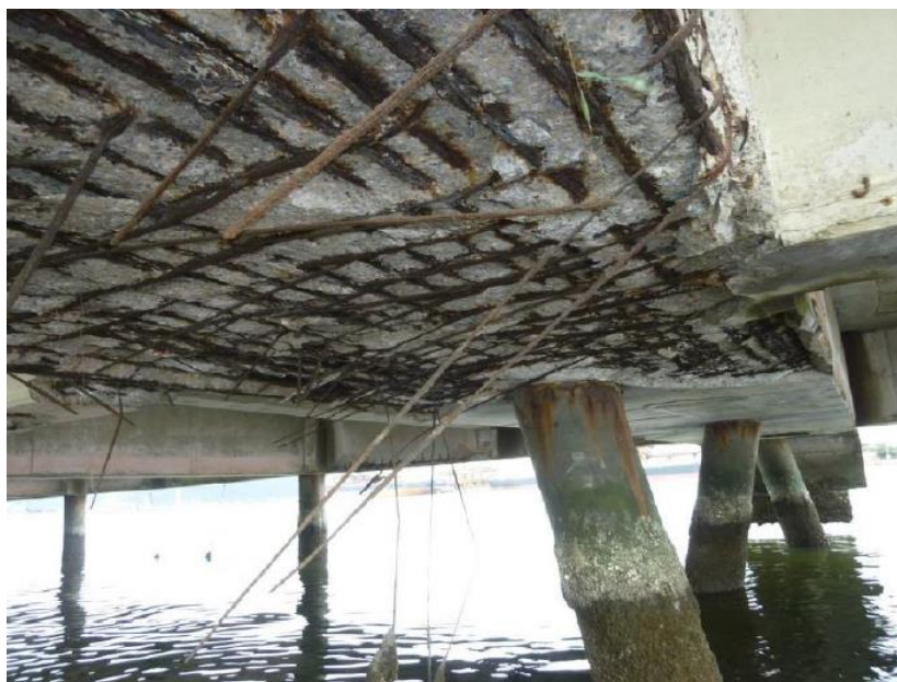
Figura 7 - Corrosão das armaduras (CARMONA, 2019).
