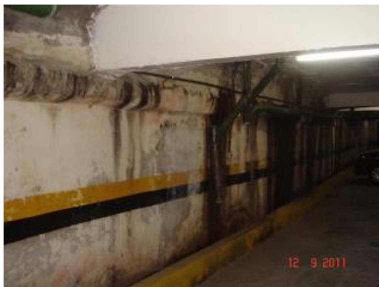
Figura 6 – Manchas de umidade em parede do subsolo (MOREIRA, 2020).
